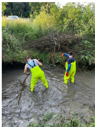
Feuerwehrkameraden beim Entfernen von Treibgut
